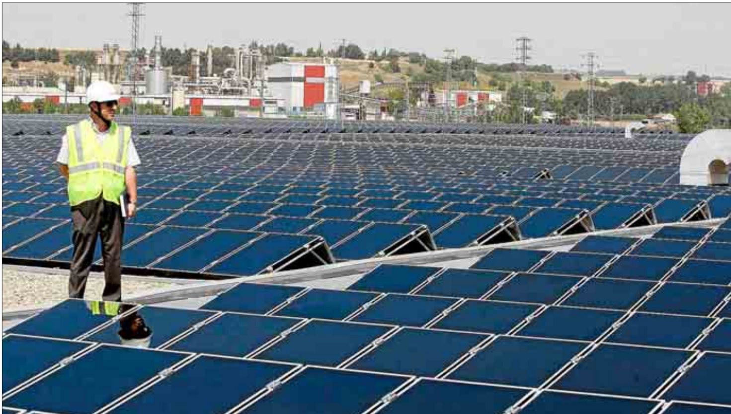
Un operario instala placas fotovoltaicas de energía solar en un tejado en un municipio de Castilla La Mancha. / EL MUNDO
